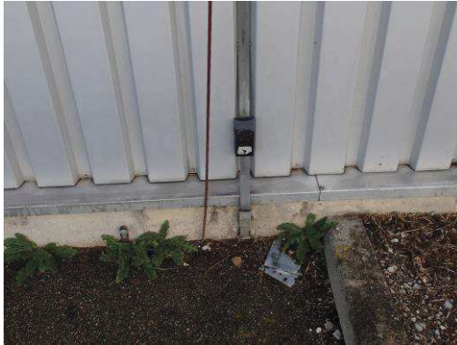
Prise de terre Sud
